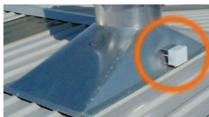
Servomotor: accionamiento automático del Registro
