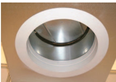
Remate lacado con Registro (falso techo)
